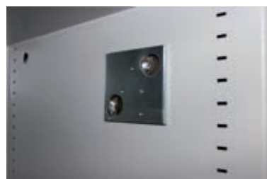
Vorbereitung für eine Alarmkomplettausstattung
